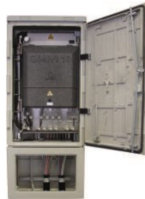
Armoires de distribution pour réseau de fibres optiques
